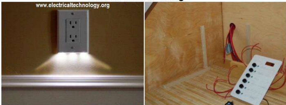
Concealed Conduit wiring
